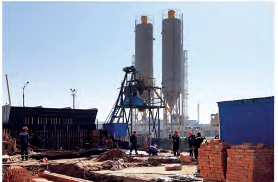
Мощность бетонно-смесительного узла позволит обеспечить бетоном все строительные работы на третьем агрегате карбамида
